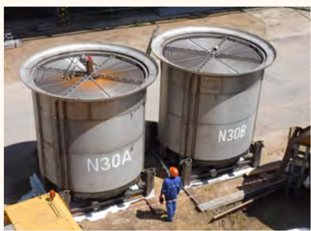
Nové rúrkové zväzky kotlov
