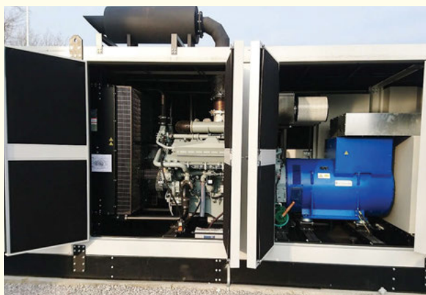
Dieselagregát 800 kW na čerpacom objekte Váh - zabezpečenie požiarnej vody v prípade výpadku elektriny, náhrada za turbo-generátor TG3.
