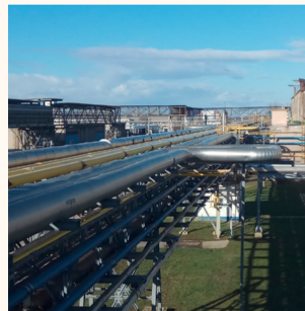
Vonkajšie nadzemné rozvody na moste B.
