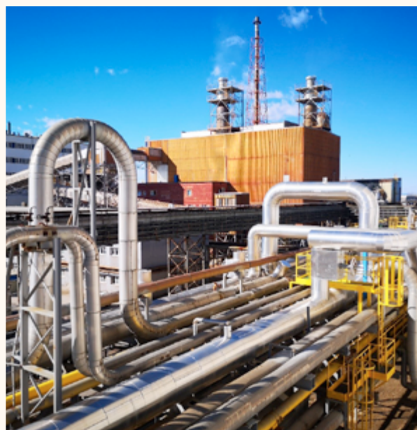
Hlavné parovody na moste K, vrátane výstupov z teplárne, v pozadí výrobná LAD.
