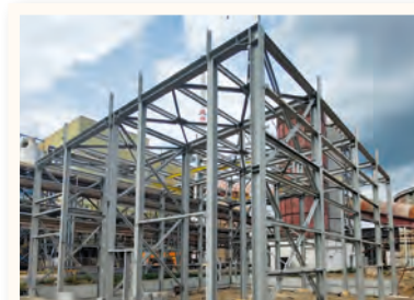
Prebiehajúca výstavba oceľových konštrukcií DASA H
