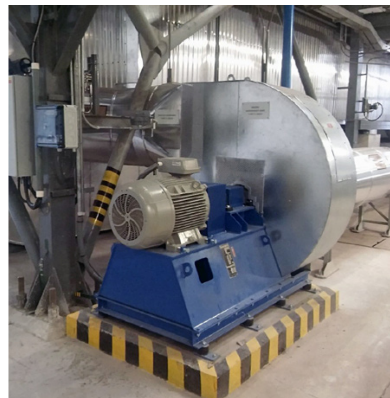
Inštalovaný ventilátor recirkulácie spalín kotla K7
