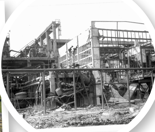
Pohľad na Hala koagulácie po požiari
