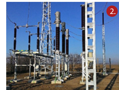
Nové pole 220 kV
