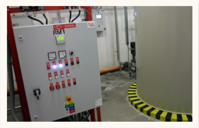
Riadiaca jednotka s nádržou na vodu
